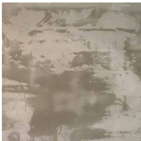
7 Ausgetrocknete erste Sanierputzlage
