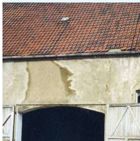
Feuchteschaden im Dachbereich
