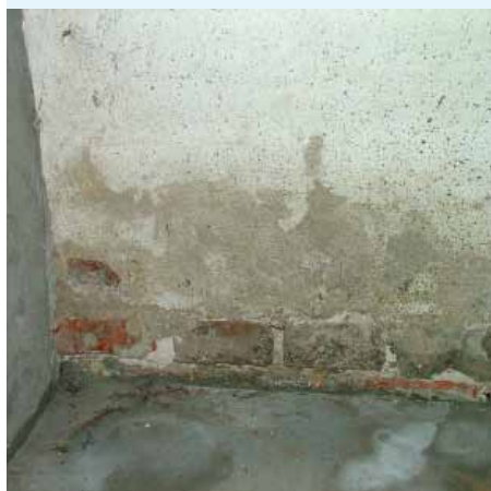
Feuchteschaden im Keller
